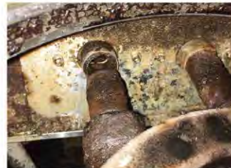
ガスバーナー配管の破損による ⇒ 一酸化炭素中毒
