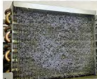
コンデンサー目詰まりによる ⇒ 冷却不良
